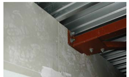
Figuur 4.1: Opening tussen dak en brandwerende wand: geen brandwerende scheiding
